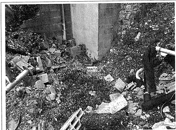
Prélèvement - MAT2 : Extérieur / Façade est - Plaque ondulée- (Présence d'amiante)
