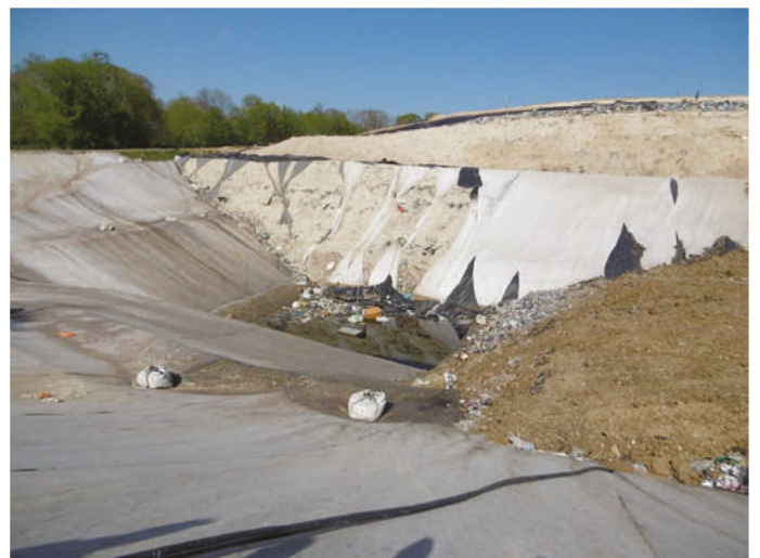
flanc C5/C7 - étanchéité détruite
