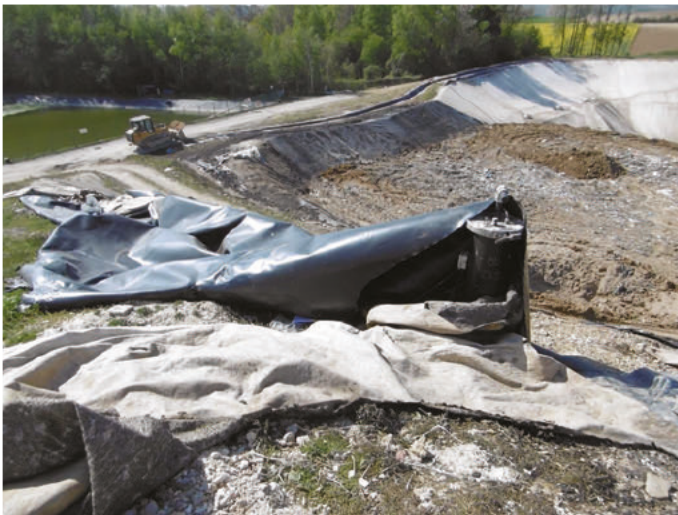
flanc côté bassin - géomembrane endommagée
