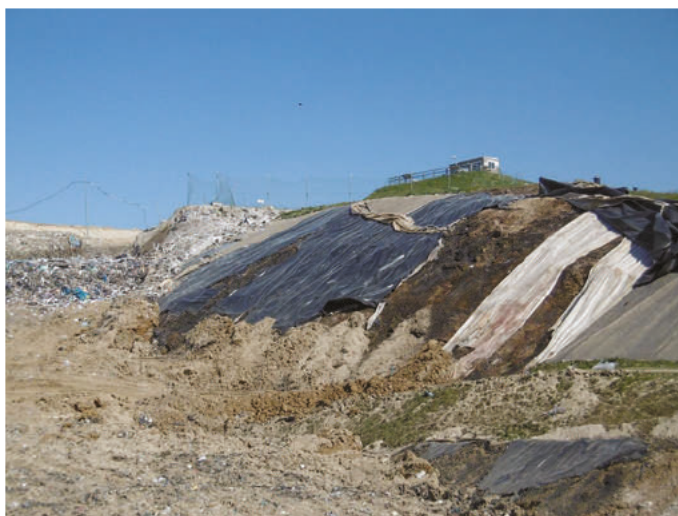
Flanc partiellement endommagé - côté casier B
