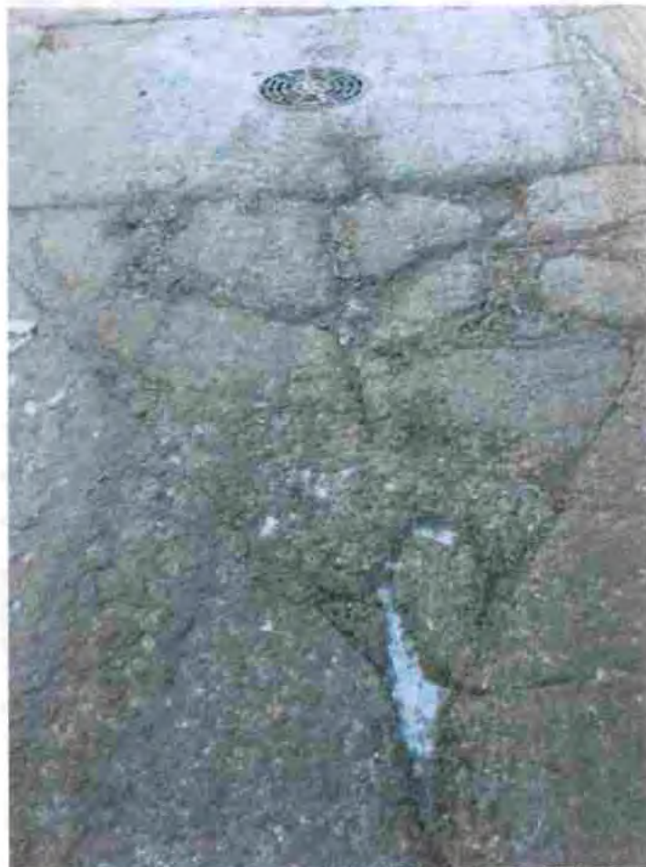
Photo 4 du 26 janvier 2021 – Défaut d'étanchéité de la voirie
