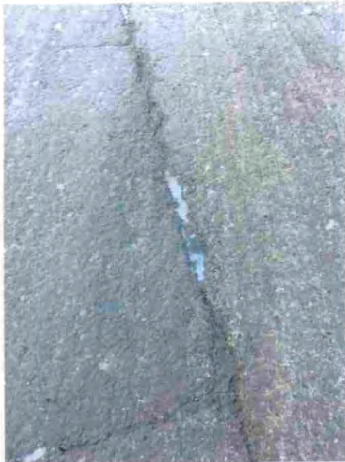
Photo 5 du 26 janvier 2021 – Défaut d'étanchéité de la voirie
