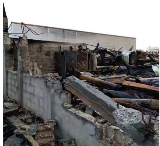
Illustration 6 : local des armoires électriques
