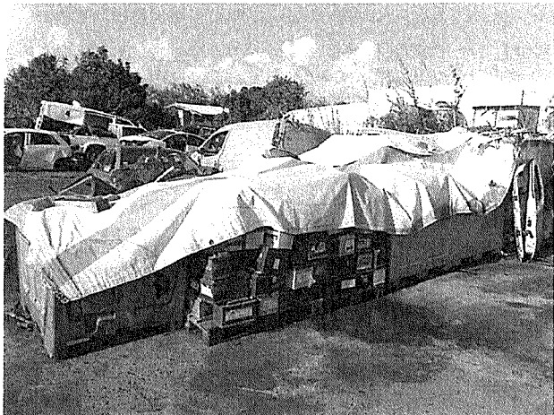
Stockage de batteries, sous rétention partielle
