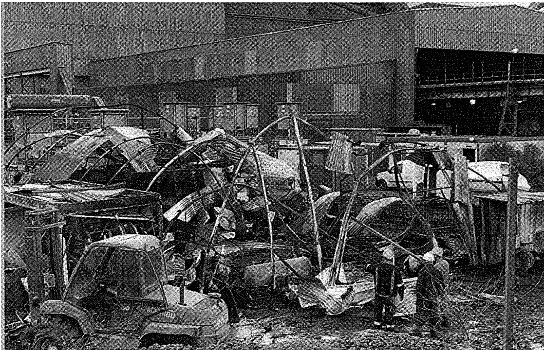
Photo 9 : Atelier après l'incendie
