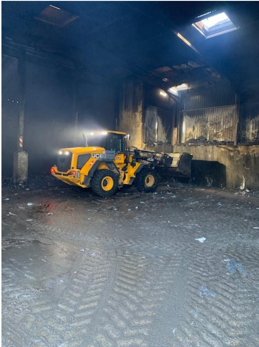
(photo prise de l'intérieur du bâtiment après l'incendie)
