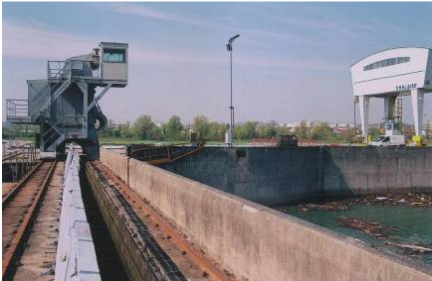
A gauche le dégrilleur, le long de la paroi, le canal de défeuillage
