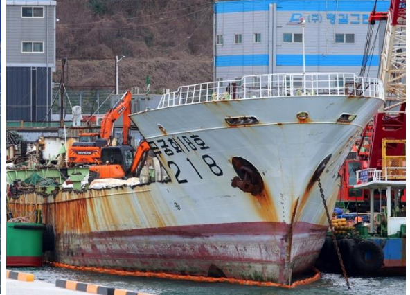
2024 : en cours de démolition au chantier Pal Pal dans le port de Busan. © Vladimir Tonic
